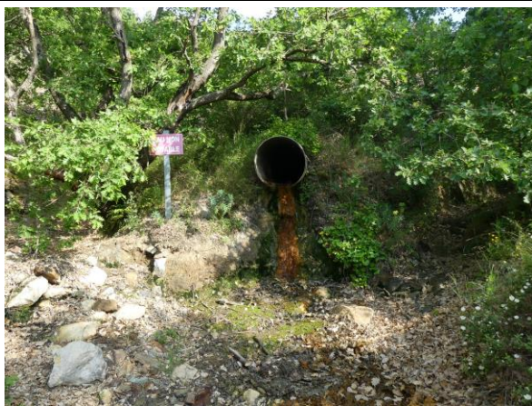
Illustration 37 : Canalisation et signalétique associée
