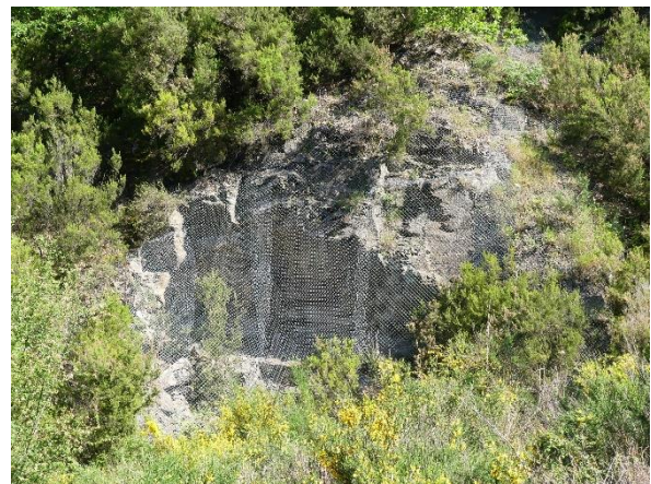
Illustration 28 : Grillage de protection en bon état
