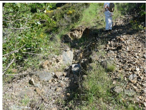
Illustration 32 : Ravine le long d'une banquette de la partie Sud
